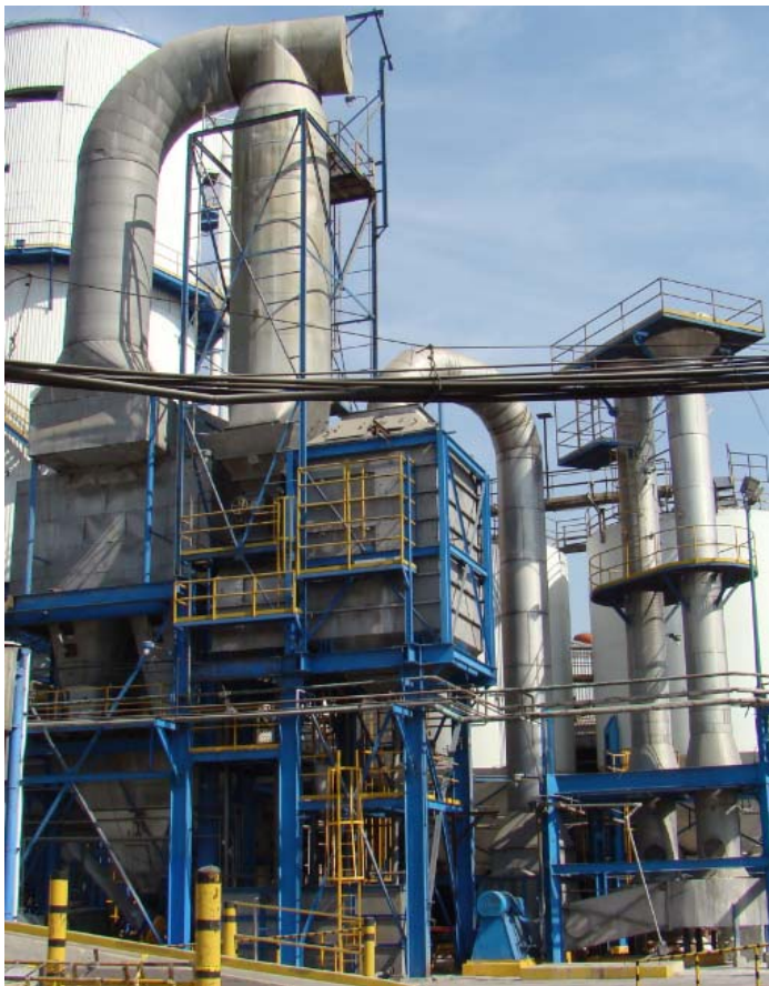
Lavador de Gases Vénturi Variable con Torre Quench en el Estado de México. Diseñado y fabricado por Comercial Aralco. Opera un flujo de 120,000 acfm.
