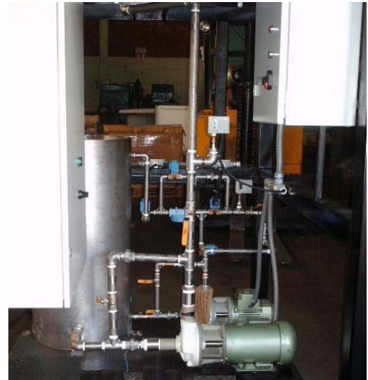
Rack de Válvulas, Moto Bombas, Niveles y Arrancadores.
